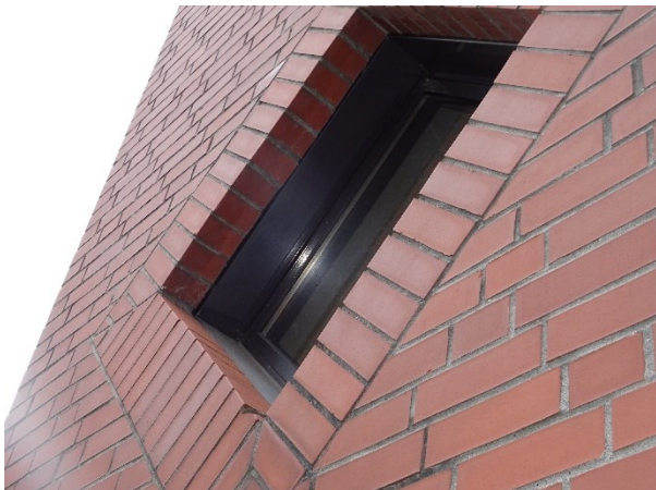
Auch diese Fensteröffnung hat keine ausreichend großen Spalten.
