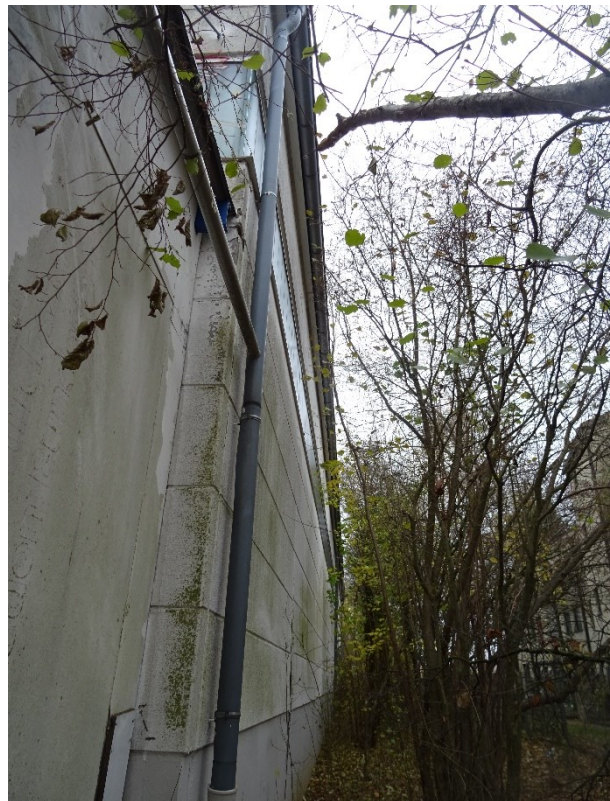
Rückseite dieser Halle, keine für Fledermäuse oder Vögel geeigneten Spalten am Rand des Dachs.
