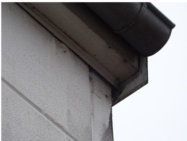
... mit Spalt unterhalb des Dachüberstands, zwar keine Anzeichen, aber potenziell „fledermausgängig“, muss nachgeprüft werden.
