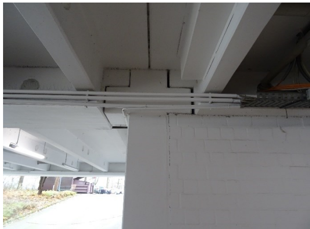
Dto.; die Spalten hier sind zu offen für Fledermäuse, sollten aber vor Abbruch nochmals auf evtl. Vogelnester (Spatzen!) geprüft werden.
