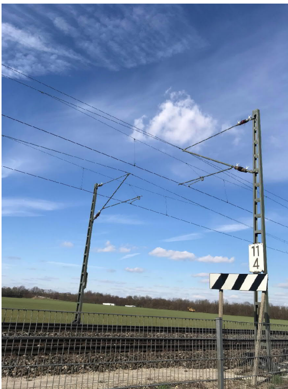
Foto 4: Oberleitungsanlagen Bahnstrecke München-Simbach
