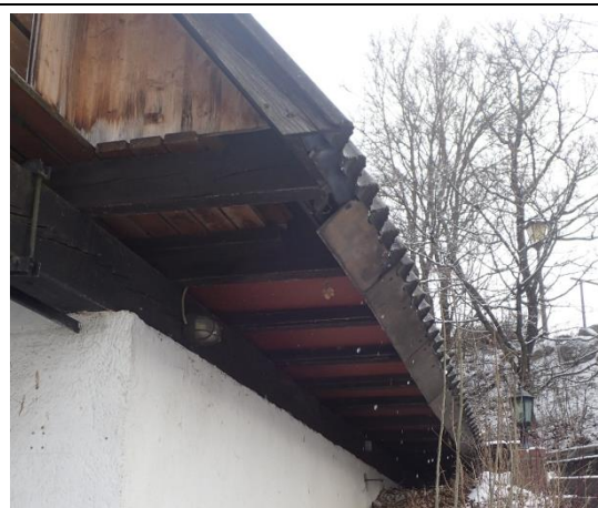
Spalten in Dachüberstand und Dachabdeckung als potenzielle Quartiere von einzelnen Fledermäusen im Stationshaus der Wasserwacht
