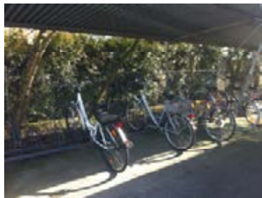
Erneuerungsbedürftige Fahrradständer am Bahnhof (Nordseite)
